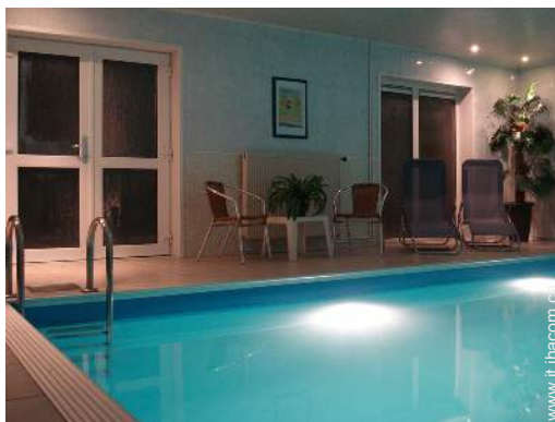
sistema di illuminazione
